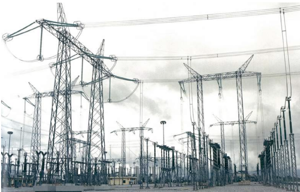
Vista de una subestación de 765 KV donde se observan pórticos, barras y conexiones a los equipos, 1986.
