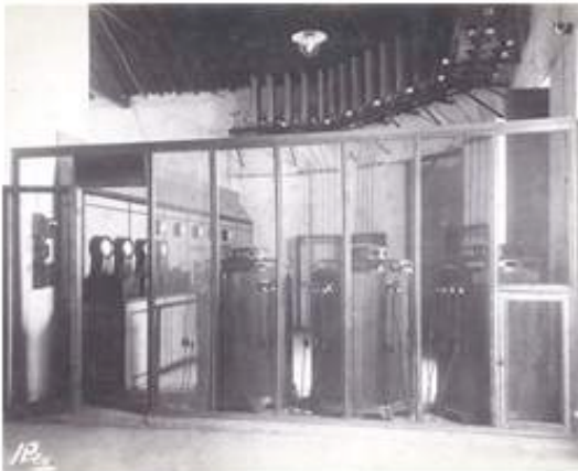
La Electricidad de Valencia, Sala de transformadores.
