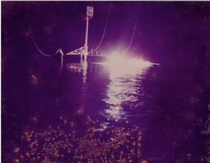
Reóstato instalado en el canal de descarga de Macagua I.
